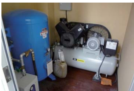
狭小空間への エアコンプレッサー設置例
