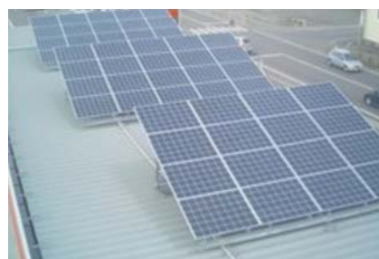
キャノピー屋根の太陽光パネル
