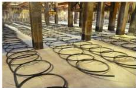
小田急電鉄東北沢駅のトンネル本体の下に設置した水平型地中熱交換器 (地表下約15m)
