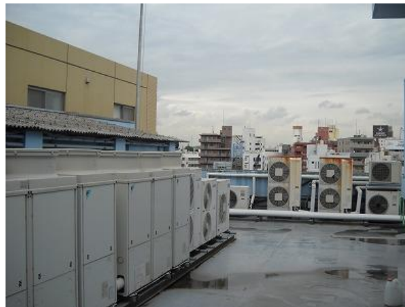
改修予定の空調機室外機
