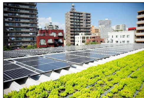
1階屋根上スペース設置太陽光発電システム（手前は残された屋上緑化）
