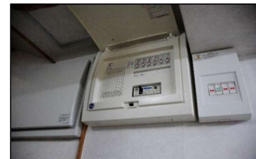
蓄電池から薬品庫へ電源供給するため新規設置された分電盤
