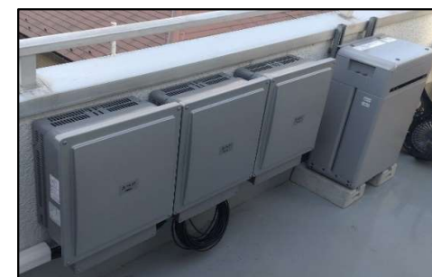
ベランダに設置したPCSと蓄電池
