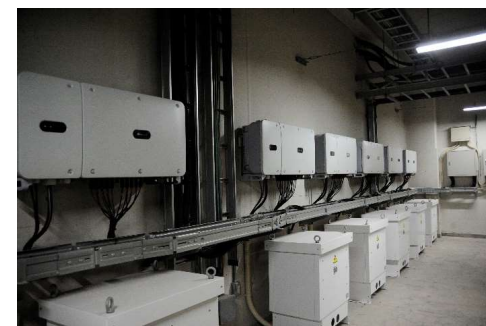
施設内受変電施設内設置のPCS
