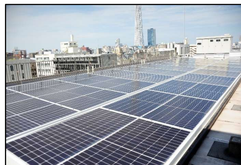
屋上設置の太陽光パネル
