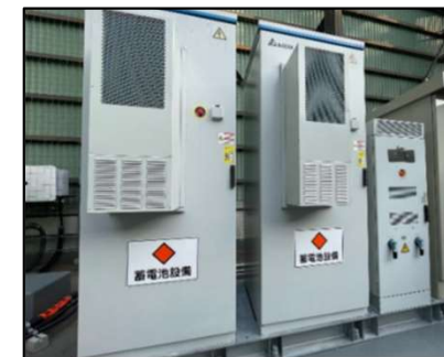
屋上隣接建屋内に設置した パワーコンディショナと蓄電池
