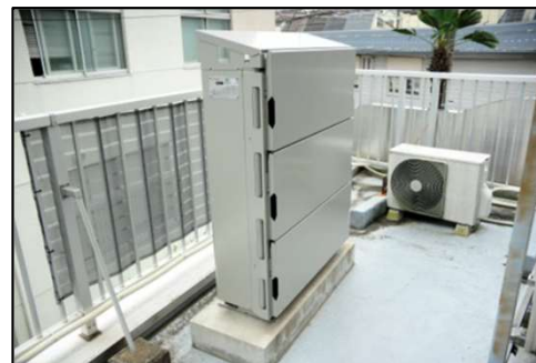
1 階屋上に設置された蓄電池
