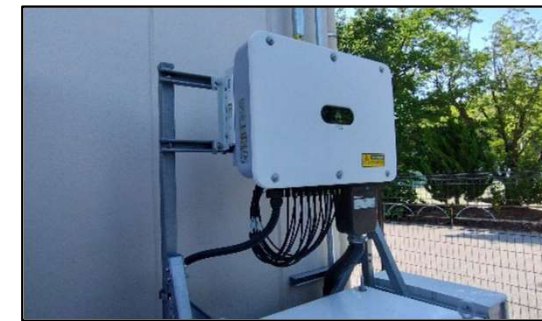
建物屋外に設置されたPCS
