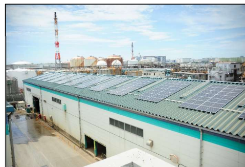
施設屋根設置の太陽光発電パネル
