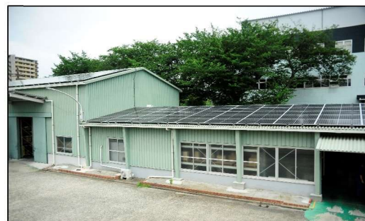
倉庫屋根設置の太陽光発電パネル
