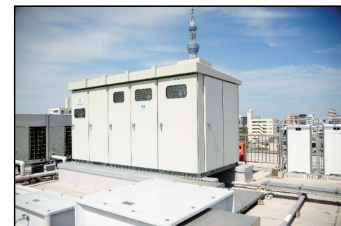
屋上設置のPCSと蓄電池
