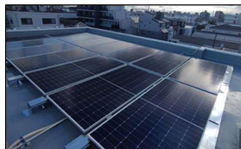
屋上屋根設置の太陽光パネル
