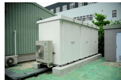
建物屋外のハイブリッド型PCS・蓄電池
