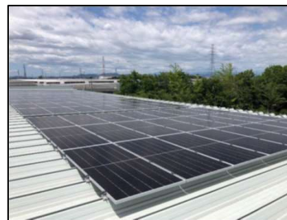
屋上部太陽光発電パネル
